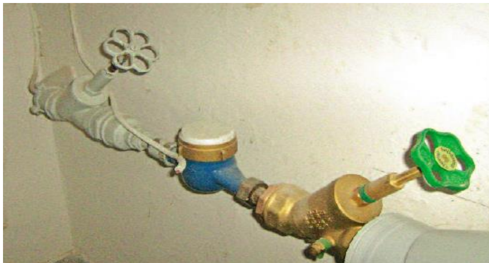
Abbildung zeigt einen Wasser-Hausanschluss eines Altbaus. Bei dieser Altanlage fehlen der Wasser-Zählerbügel und der Potentialausgleich.
